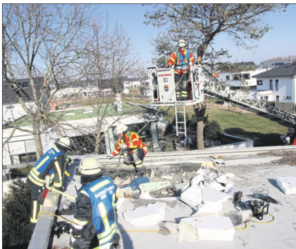
DIE DACHPAPPE DER SCHWIMMHALLE an der Sebastiansschule in Neuthard hat aus ungeklärter Ursache Feuer gefangen. Foto: Herberger
